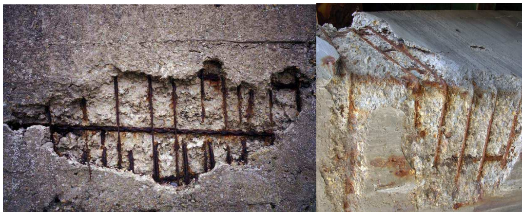
Рис. 4. Руйнування залізобетонних конструкцій внаслідок тривалих корозійних впливів
