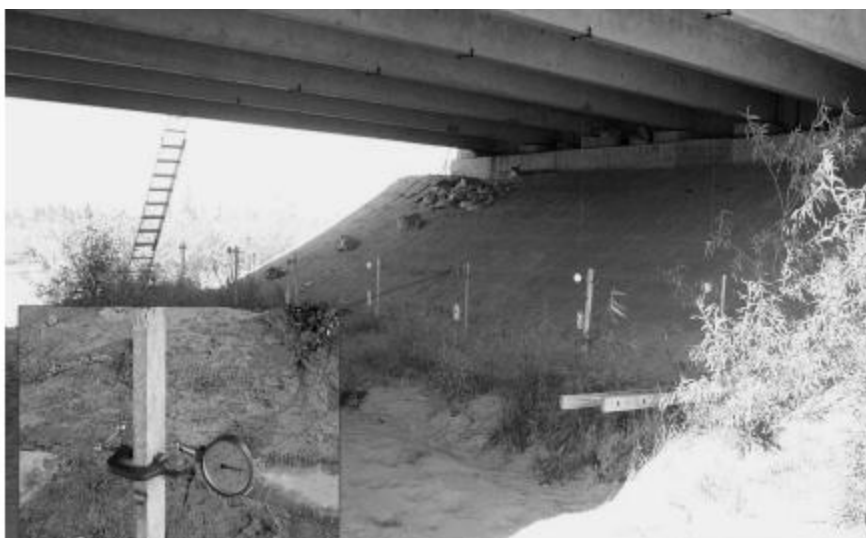
Рисунок 1.4. Установка прогиномірів типу ПАТ-6 в розрахунковому перерізі L/2 прогонової будови автодорожнього моста.
