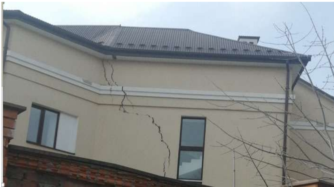
Рисунок 2 – Тріщина з Північно-Східної сторони будівлі Костелу Зішестя Святого Духа
