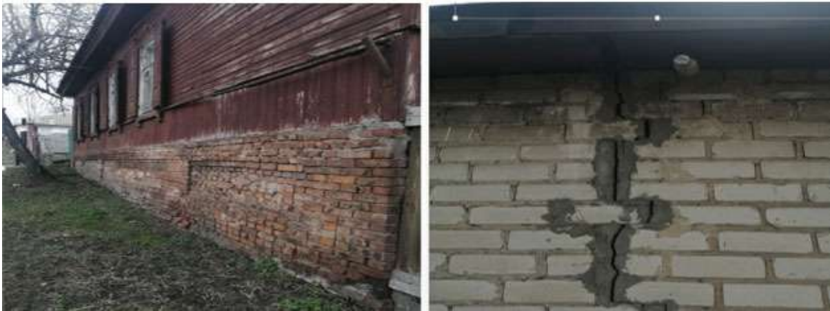
Рисунок 1 – Виявлені об'єкти з деформаціями по вул. Київській в м. Чернігів
