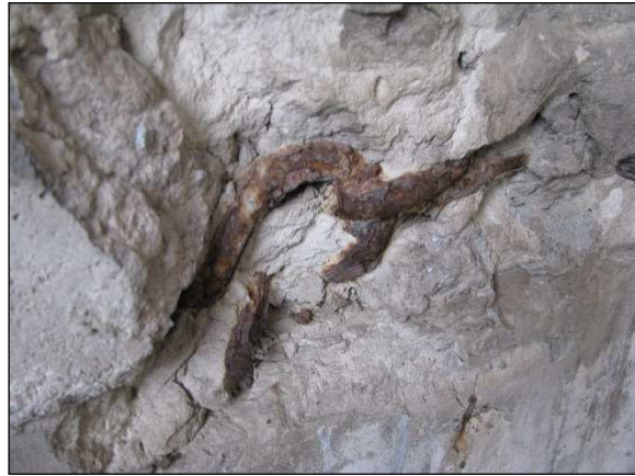
Рис. 4 – Корозія закладних деталей стиків стінових панелей і панелей перекриття
