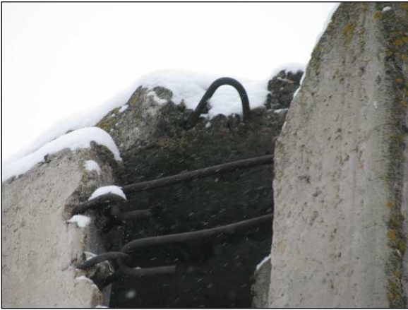
Рис. 3 – Корозія закладних деталей стиків стінових панелей і панелей перекриття
