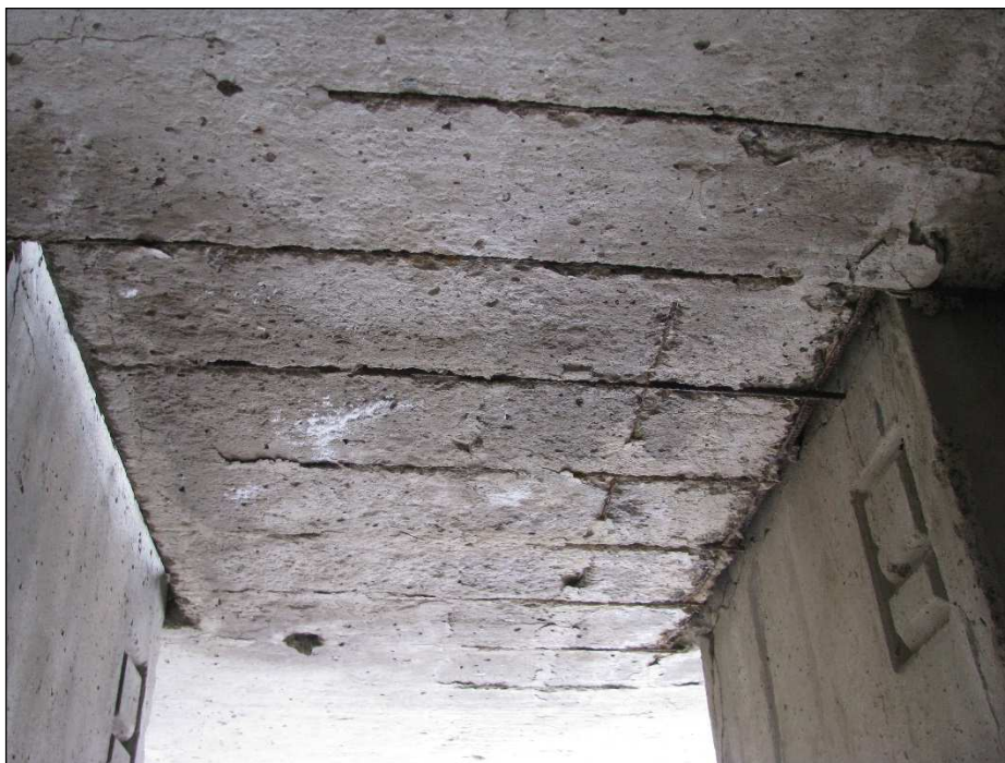
Рис. 5 – Корозія робочої арматури, руйнування захисного шару бетону панелей перекриття
