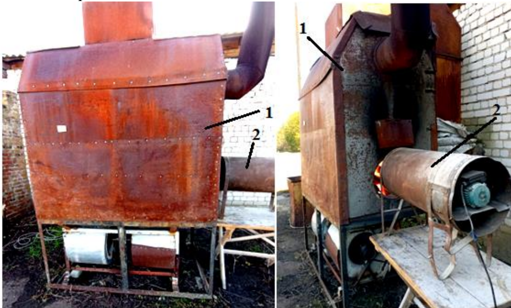
Рис. 1 – Фото твердопаливного котла (1) з турбіною (2) для роздуву полум'я
