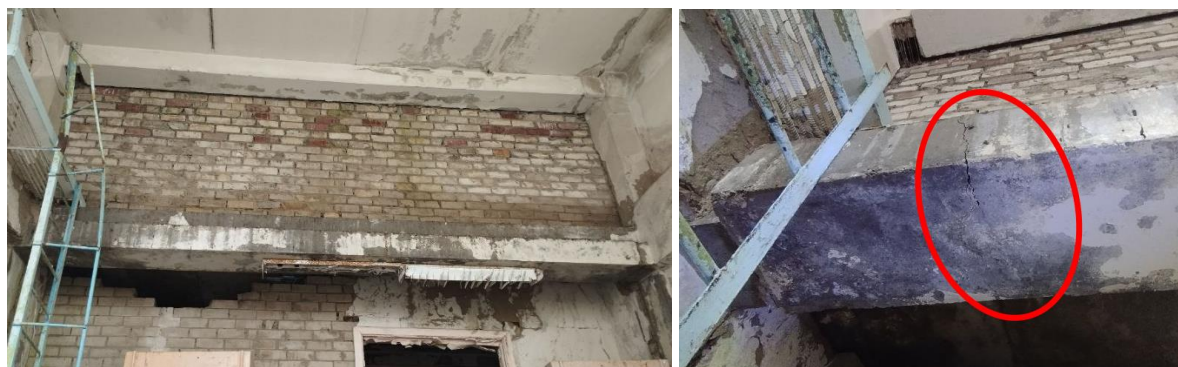
Рис. 1 – Пошкодження ригеля: а – загальний вид ригеля; б – тріщина, що виникла внаслідок воєнних дій
